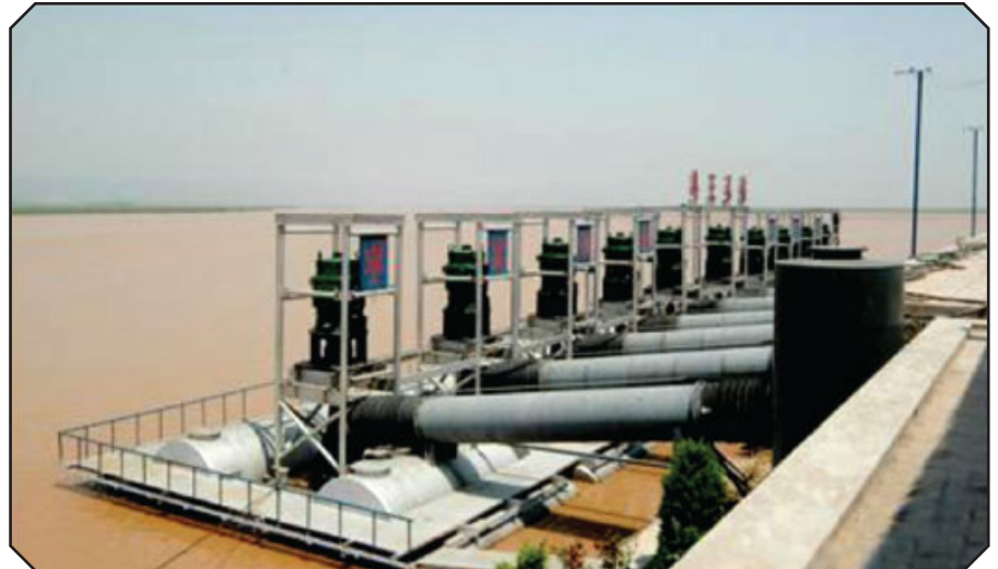
Station de pompage flottant sur le fleuve Jaune
