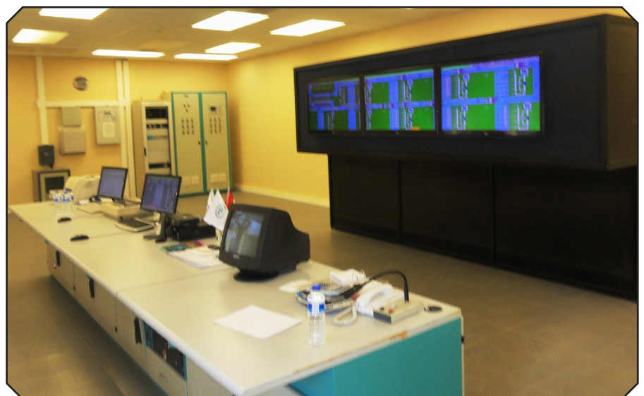
Une vue de la salle de contrôle
