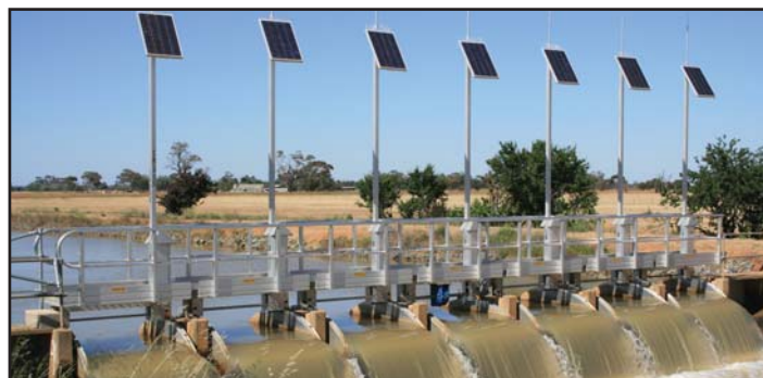
Vannes de réglage du débit automatique
